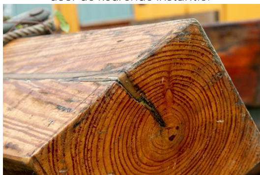
Figuur 5.15: Reparatie die losgekomen is van het omliggende hout
