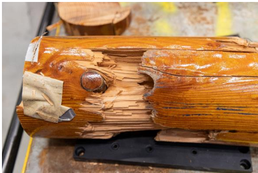
Figuur 5.6: Een losse kwast die geheel losgekomen is van het omringende hout
